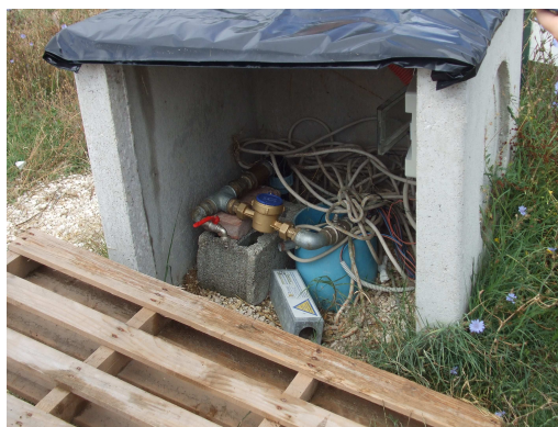
Fig. 7 – Pozzo e relativo sistema di contabilizzazione
