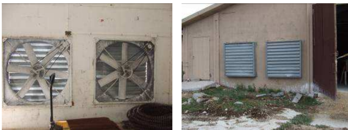
Fig. 4 – Sistema di ventilazione forzata
