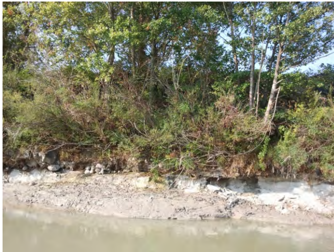
Fig. 59 - Scogliera in massi (OL 4) cementata alla base. Risulta scalzata e aggettante rispetto al resto della sponda. Era appoggiata sul bedrock argilloso che è stato eroso per almeno 1,3 m.
