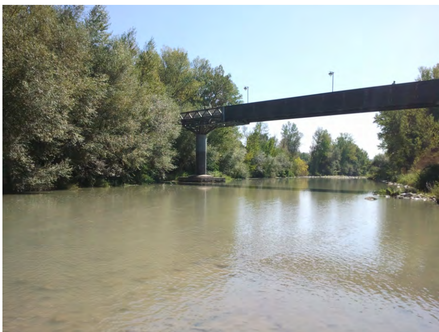
Fig. 67 - Ponte pedonale (OT 5), visto da monte. Non è possibile verificare le condizioni del pilone presente nel canale.
