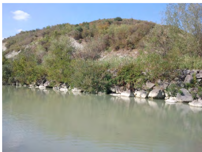
Fig. 62 - Scogliera in massi (OL 6), si presenta in buone condizioni.
