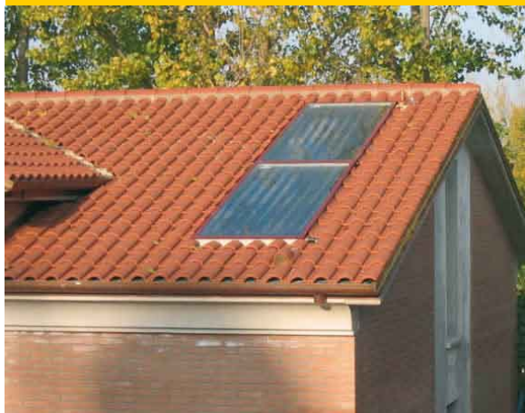
Pannelli solari termici in casa residenziale.
